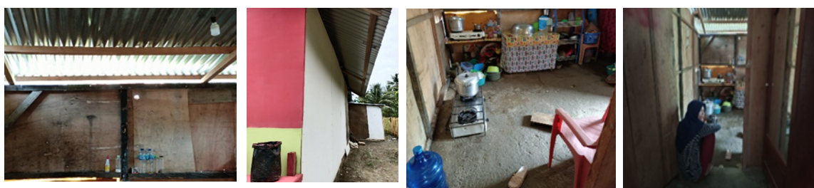
Gambar 4. Kondisi dinding, kondisi samping rumah, kondisi lantai dan kondisi ruangan pada rumah warga
